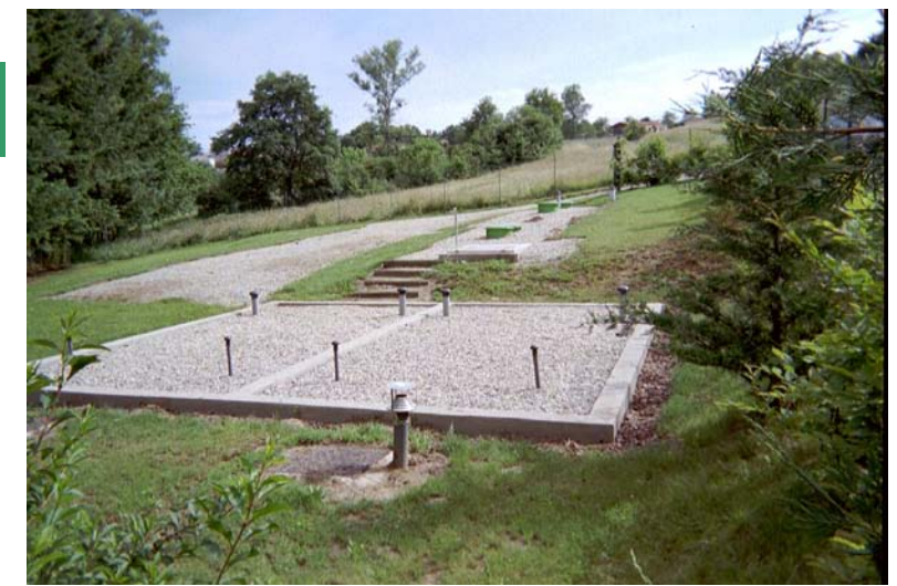
A droite : Station d'Estandeuil (63), 530 m d'altitude A gauche : Implantation d'une filière d'assainissement autonome
