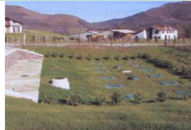
A gauche : Station de 100 EH (12 filtres à tourbe)
