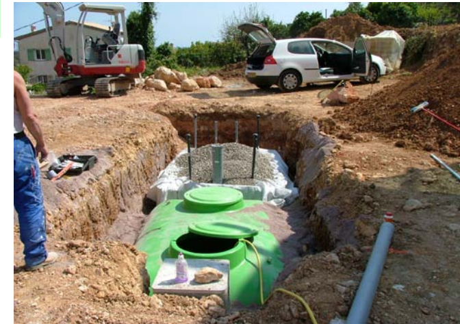
(Fosse Toutes Eaux au premier plan)
