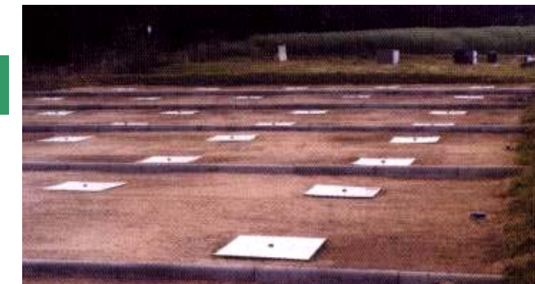
A droite : Station de La Brosse (78) – 250 EH
